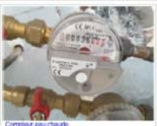
Compteur eau chaude
