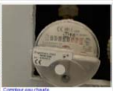
Compteur eau chaude
